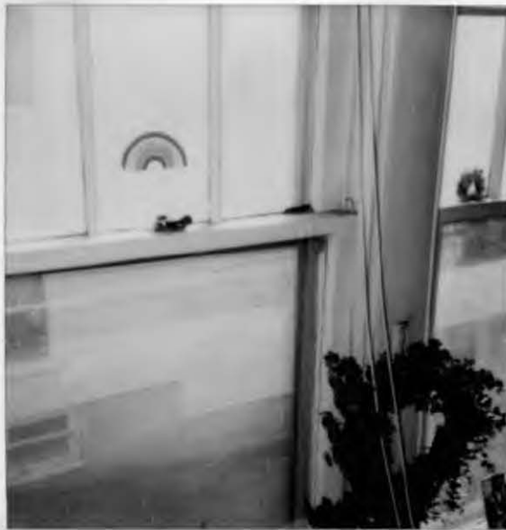
Patch - 7112 Sycamore Av T.P. window is broken sash cords
